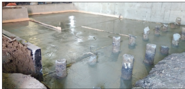
Рис. 2. Фрагмент выпусков буронаблюдательных свай ЭРТ Fig. 2. Fragment of releases of EDT bored injection piles
